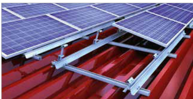
Klemmsystem: Südausrichtung auf Ost-West-Dach
