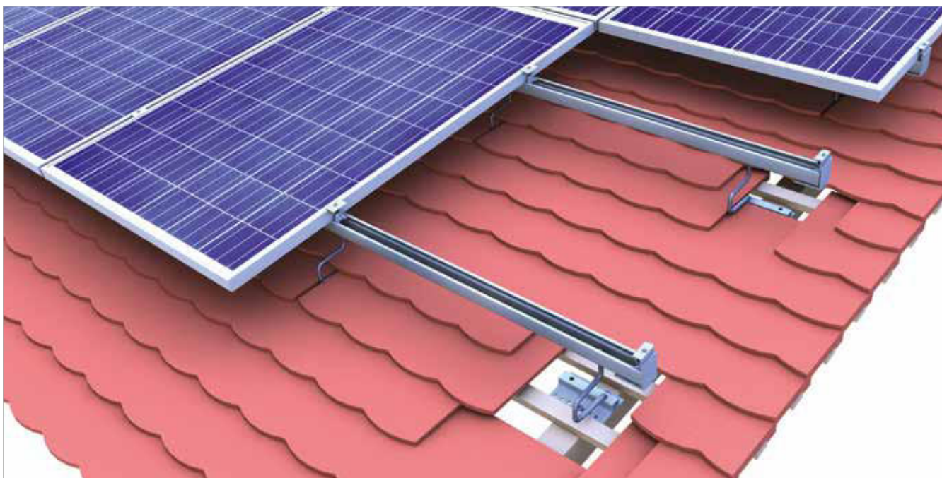
novotegra top-fix – Klemmsystem einlagig auf Biberschwanzeindeckung mit hochkant montierten Modulen
